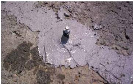
Рисунок 2. Герметизация пакера, установленного на поверхности и трещины при использовании соответствующего средства MasterBrace/MasterFlow
